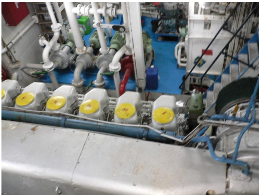
Foto N° 21, Vista parcial da Sala de Máquinas.
